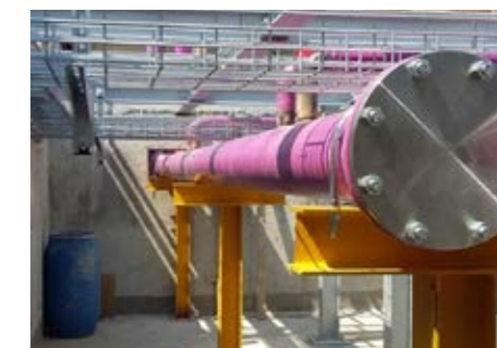
Realiz. Piping di Raffreddamento
